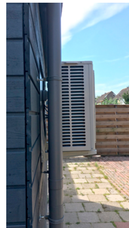
Bij de NOM-renovaties is gekozen voor warmtepompen
