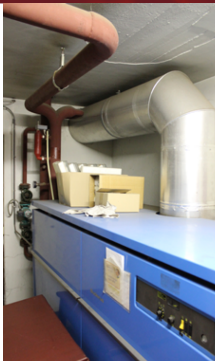
Heteluchtverwarmingsinstallatie van de Sint Petruskerk te Eindhoven. © Maarten Vieveen.
